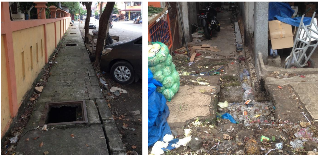
Gambar 3.68 Penutup Drainase Ada dan Sampah di Saluran Drainase
